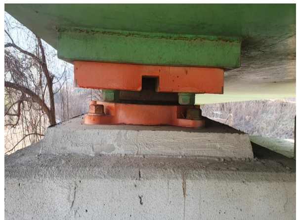
P1 받침 부식 임시조치(도장보수) 전 현황
