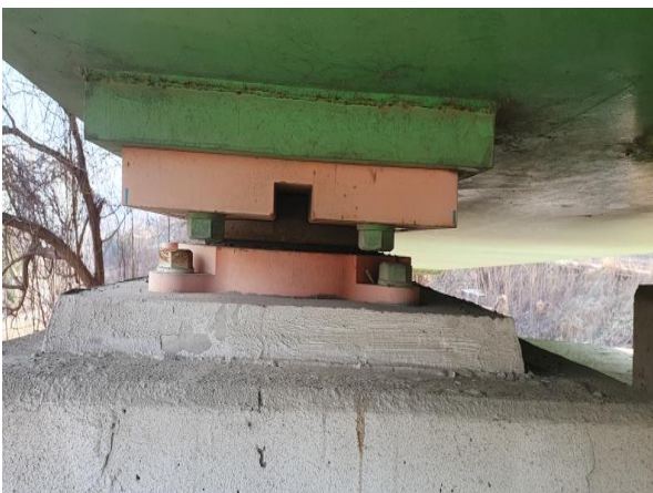
P1 받침 부식 임시조치(도장보수) 전 현황
